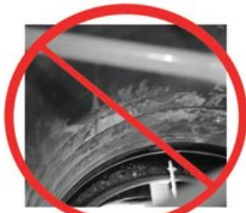
Inapropiado ajuste de la válvula TXV
